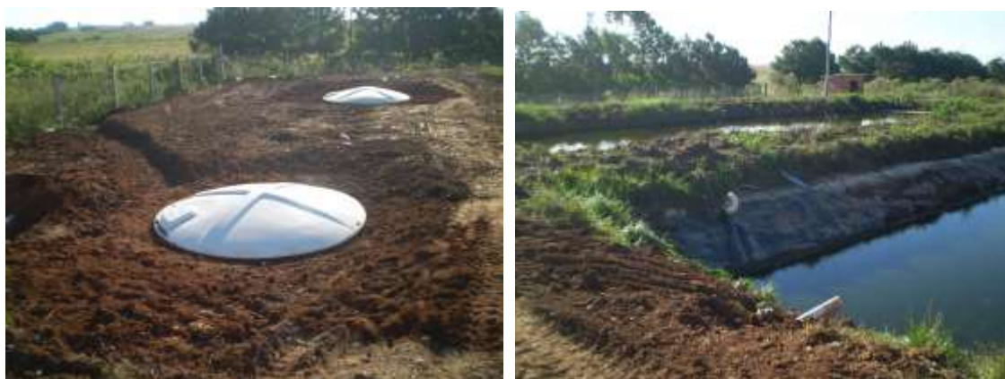
Figura 34: Sistema de tratamento do percolado Fonte: Secretaria Municipal do Meio Ambiente
